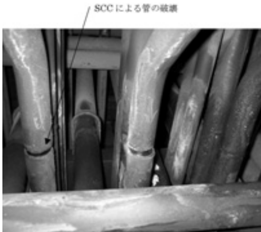
図1 過熱器管の損傷状況
