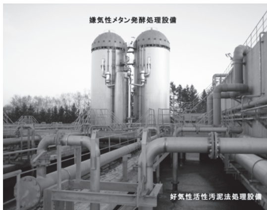
図2 排水処理プラントの一例 (工場排水処理設備外観)
