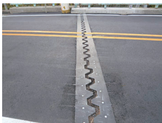
図2 遊間のある健全なフィンガージョイント (1)
