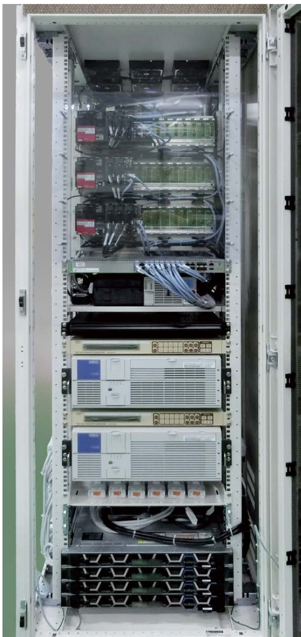
図1 発射管制設備（ラック）（LCS）
